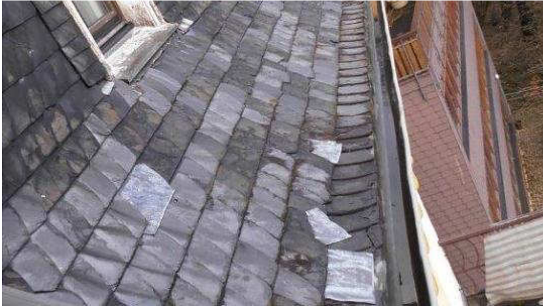
Das marode Dach der Troxler-Schule: Schieferplatten hängen schief, weil die Nägel in der morschen Holzschalung nicht mehr halten. FOTO: Troxler Schule
